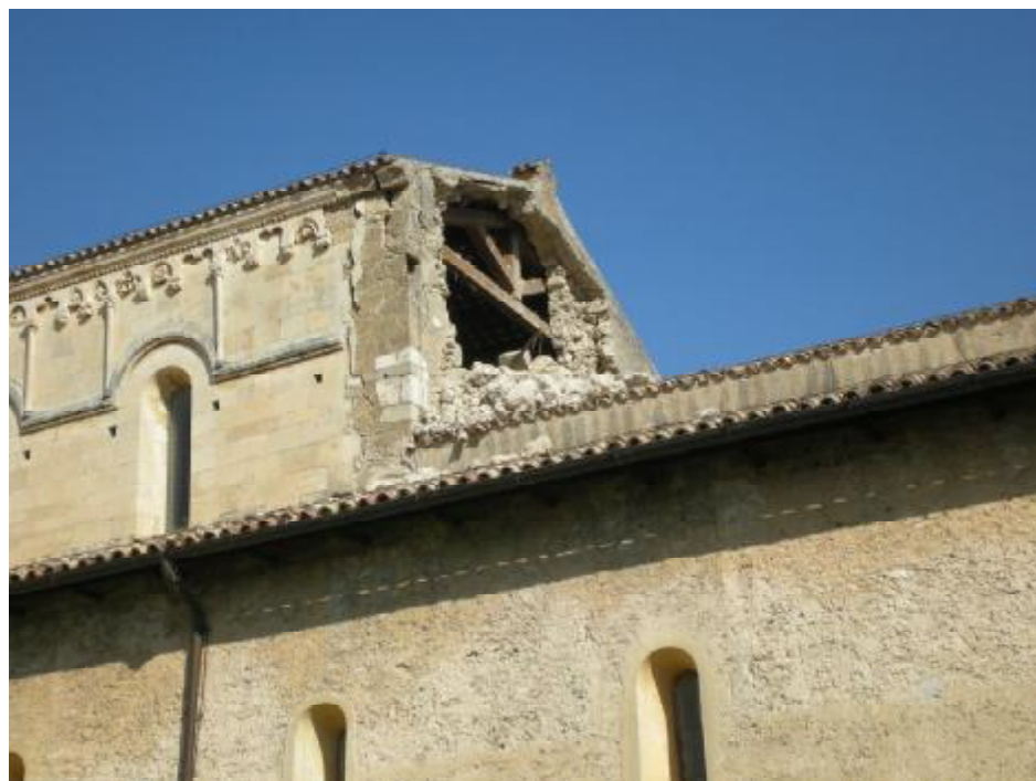
Figura 14: Abbazia di San Clemente a Casauria dopo il terremoto del 6 aprile 2009.
