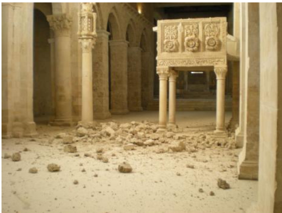
Figura 13: Abbazia di San Clemente a Casauria dopo il terremoto del 6 aprile 2009.
